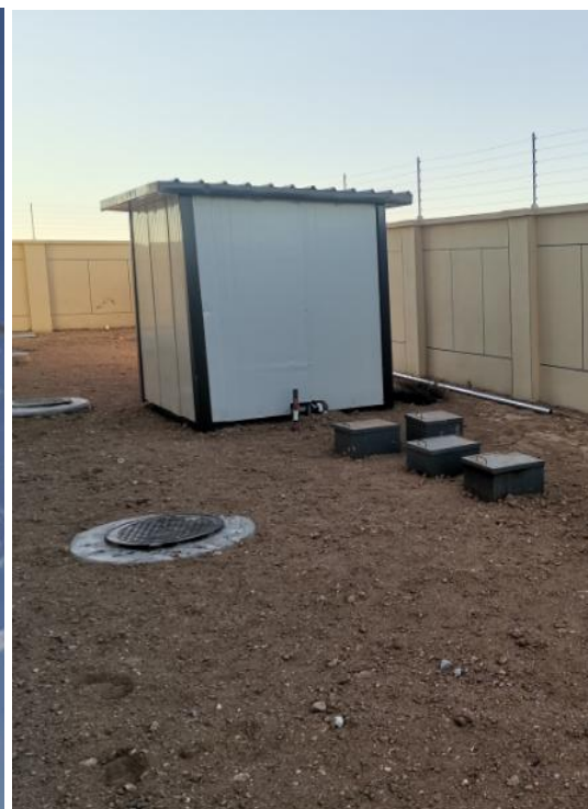
升压站污水处理设施
