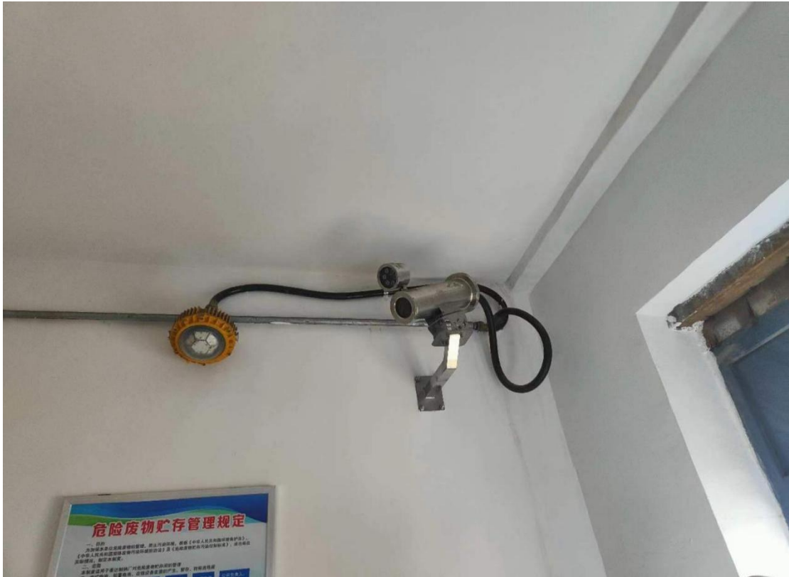
监控及照明系统
