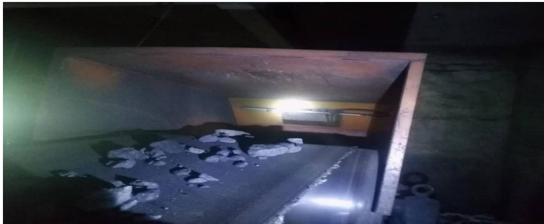
皮带处喷淋设施
